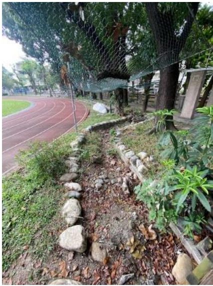
說明：原有水道損壞雜亂危險
